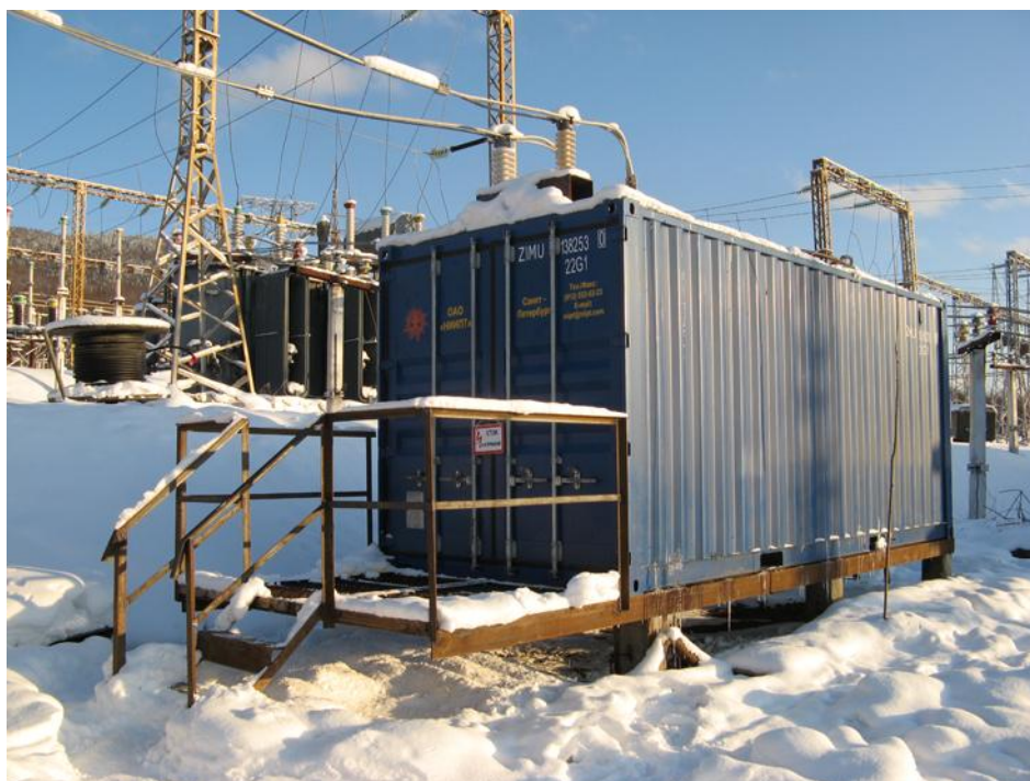
ВУПГ-14/1200 на подстанции 220 кВ Тымовская, ОАО «Сахалинэнерго»
